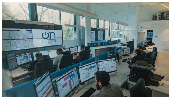
Puesto de Control Conectado, Dijon Métropole
